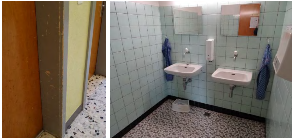
Cadre de porte endommagé
