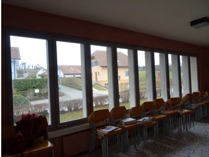
Fenêtres du foyer d'entrée, remplacement nécessaire
