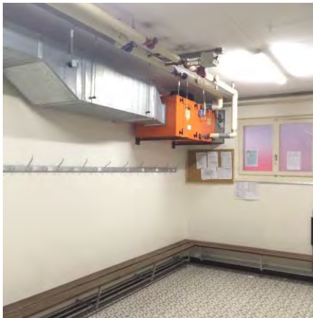
Ventilation des vestiaires
